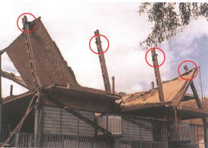
شکل ۸) شکست اتصال خورجینی در اثر زلزله و فرو ریختن کل سقف
